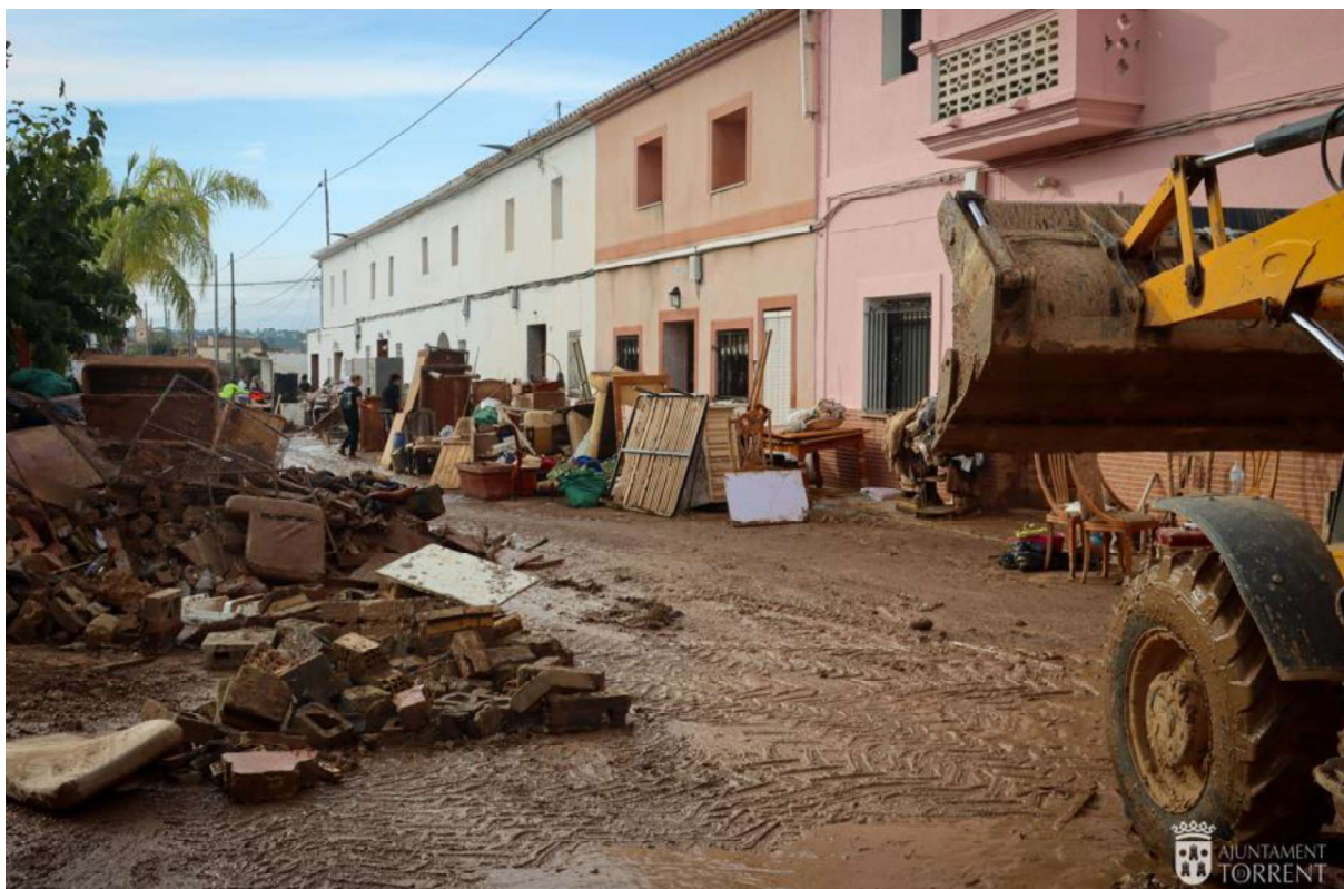
Figura 14: Viviendas en Torrent tras la DANA
