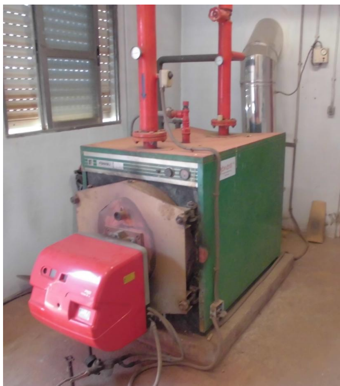
Ilustración 1: Caldera del colegio Juan XXIII
